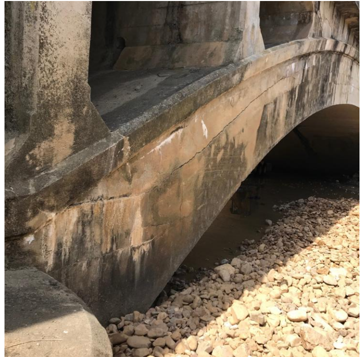
Imagen 1. Fisura en arco.
