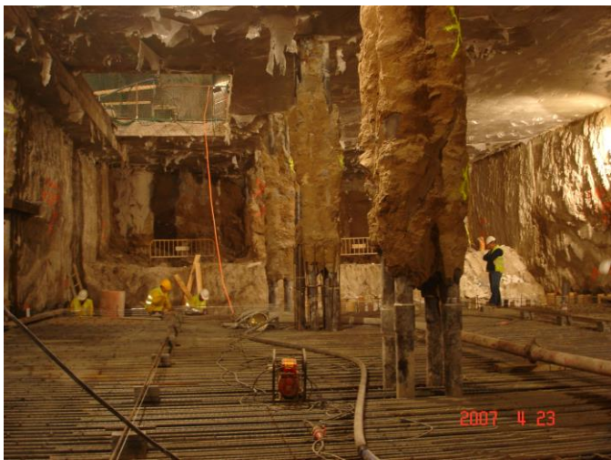
Micropilotes terminados, una vez realizada la excavación del vestíbulo inferior. Estación L9 Fira.
