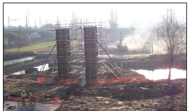
Vista general de la obra, al fondo carro perforador perforando en la zapata central.
