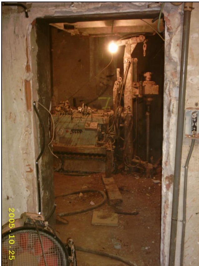
Equipo de perforación Tes20 perforando en el interior del sótano del edificio
