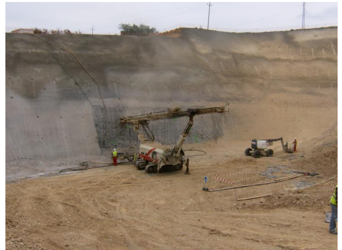
Equipo de perforación Casagrande Pg115, realizando paraguas de micropilotes. Túnel Feixes Norte.
